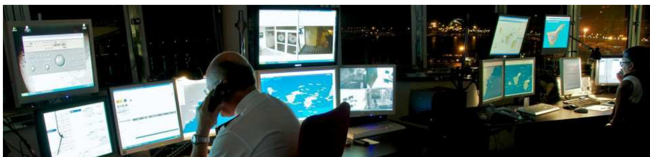
Centro de control de operaciones
