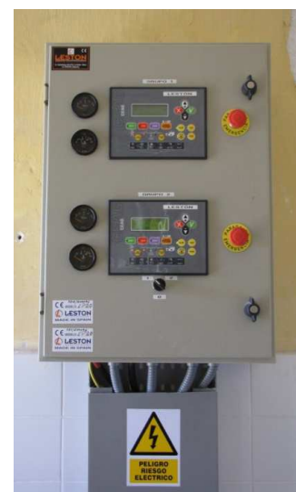
Cuadro de Automatismo de Grupo
