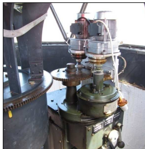
Sistema con motor eléctrico
