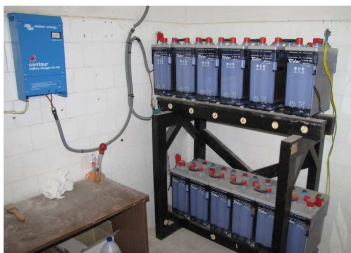
Baterías de reserva en el Faro de Garrucha
