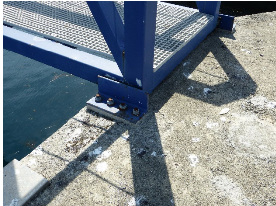
Imagen. 36. Apoyo 34B, muy en borde de hormigón. Previsibles daños futuros en el hormigón del D.A.. Neopreno lateral desplazado, previsible caída.
