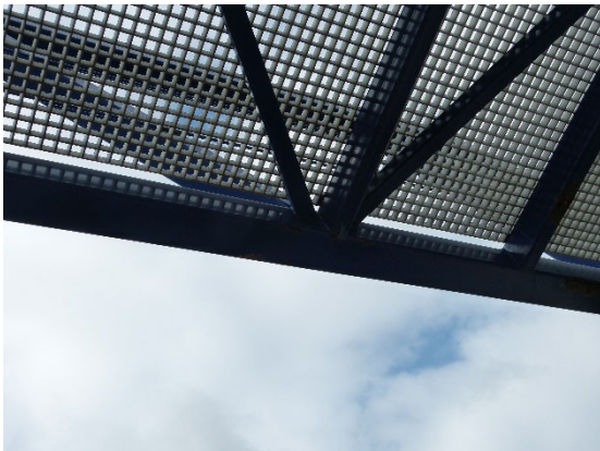
Imagen. 5. Picaduras en unión soldada montante con cordón inferior, nudo 32A.
