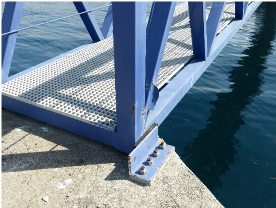
Imagen. 35. Apoyo 34A, muy en borde de hormigón. Previsibles daños futuros en el hormigón del D.A.. Neopreno lateral desplazado, previsible caída.
