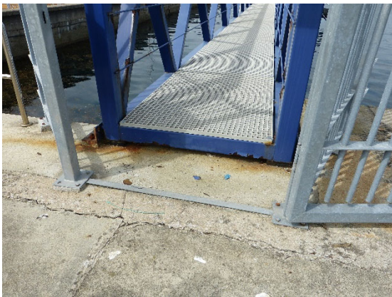
Imagen. 19. Montante eje1 muy deteriorado. Ausencia de pintura y pérdida de sección en perfil. Apoyo pasarela en borde muelle, posibles patologías futuras. Neoprenos laterales sueltos, posible pérdida.
