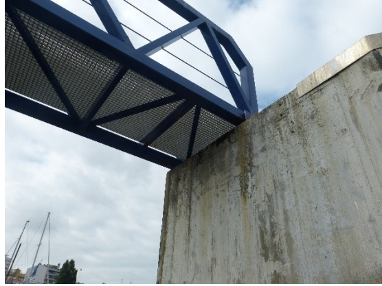
Imagen. 4. Ausencia de pintura en paramento inferior del montante eje 33.
