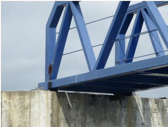
Imagen. 17. Desprendimiento pintura en diagonal del nudo 34A.
