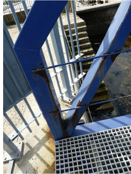
Imagen. 22. Montante y diagonal en eje A con corrosión en zona de unión con baranda. Defecto de construcción, acumulación de agua/humedad.
