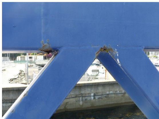
Imagen. 26. Picadura en soldadura de unión de diagonales y cordón superior en eje A.
