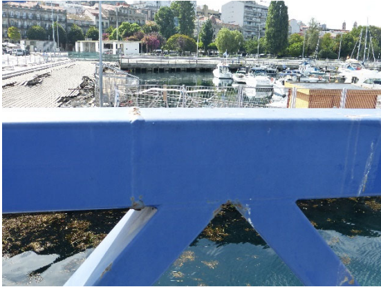
Imagen. 27. Inicio oxidación en soldadura del nudo 12A.
