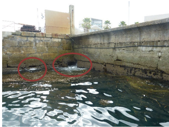
Imagen. 16. Zona muelle con pérdida de sillares. Mar socavando relleno. Zona a reparar
