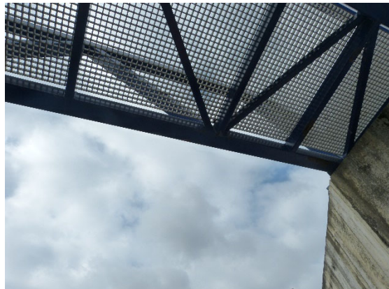
Imagen. 6. Varios puntos sin pintura del cordón inferior eje A, llegando a duque de alba.
