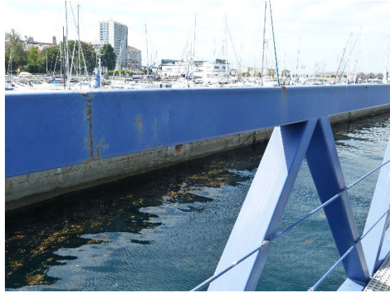
Imagen. 28. Inicio oxidación en soldadura del cordón superior en nudo 17A.
