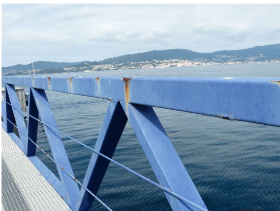
Imagen. 25. Picaduras en cordón superior de eje B, entre ejes 8 y 10.
