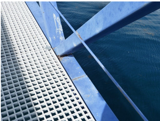
Imagen. 31. Inicio oxidación en soldadura del nudo 17B. Inicio corrosión en soldadura del cordón inferior.
