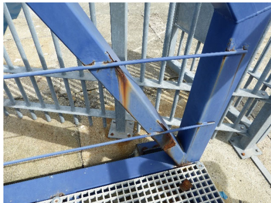
Imagen. 20. Diagonal en eje B con corrosión en zona de unión con baranda. Defecto de construcción, acumulación de agua/humedad.
