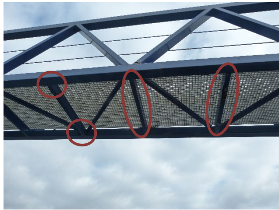
Imagen. 10. Daños en paramento inferior. Pérdida de pintura en centro luz de montante, corrosión en unión soldada. Ejes 13, 14 y 15.
