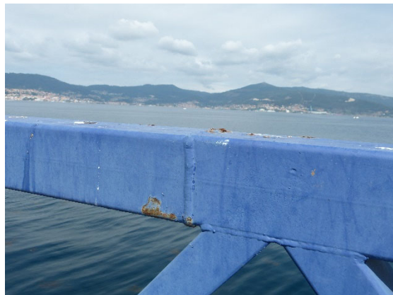
Imagen. 32. Picaduras en soldadura del cordón superior en nudo 22B.
