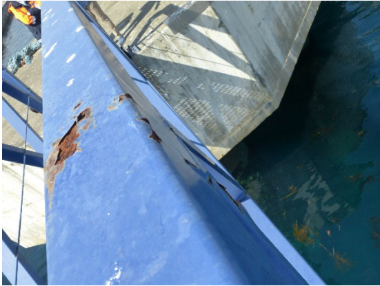
Imagen. 33. Picaduras en soldadura del cordón superior en nudo 22B.
