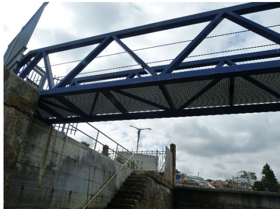
Imagen. 14. Picaduras cordón inferior eje B.
