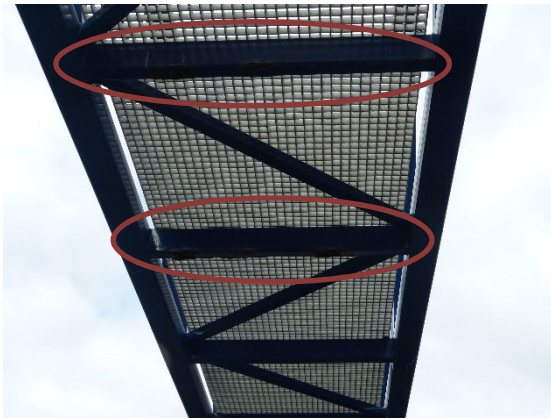
Imagen. 9. Corrosión parte inferior montantes ejes 21 y 22.
