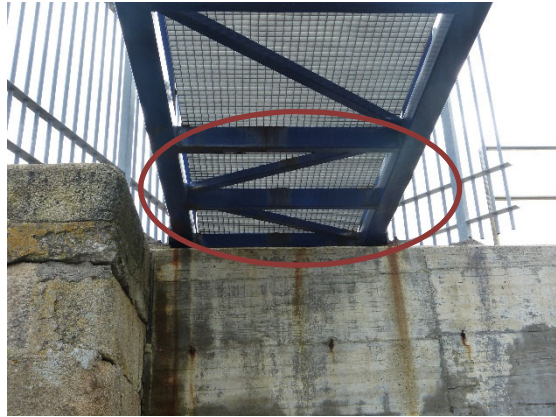
Imagen. 12. Pérdida de sección acusada en centro luz de las diagonales y montantes, ejes 1, 2 y 3.
