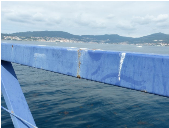
Imagen. 29. Inicio oxidación en soldadura del cordón superior en nudo 17B.
