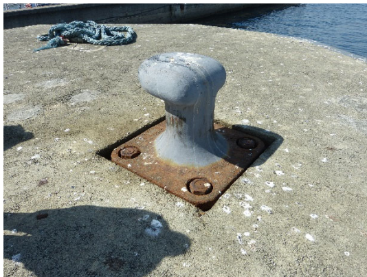
Imagen. 37. Noray con inicio oxidación en base. Necesidad de limpieza y pintado.
