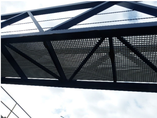
Imagen. 13. Pérdida de en montantes, ejes 5 y 6. Picaduras cordón inferior eje B.
