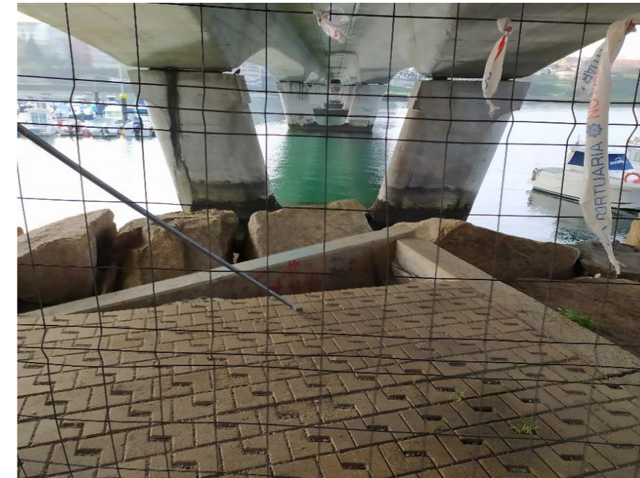
Imagen 15 Detalle de las patologías existentes en el muro de escollera.
