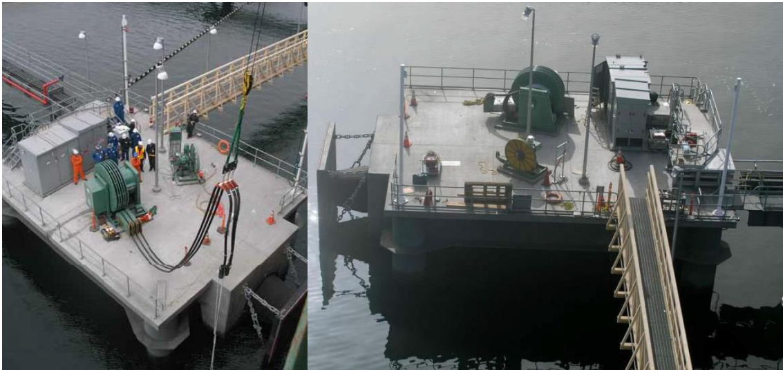
Figura 12. Sistema de gestión de cables y conexión muelle-buque en un duque de alba del Puerto de Long Beach, para el suministro eléctrico a petroleros de BP. Fuente: Port of Long Beach.
